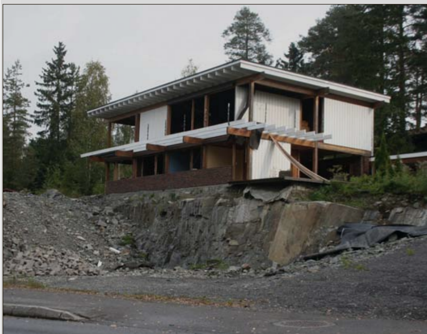
FORLATT: Løkenåsveien 40 står igjen som en byggeplass etter at utbygger gikk konkurs og kommunen trakk byggetillatelsen. FOTO: LINDA INGIER
