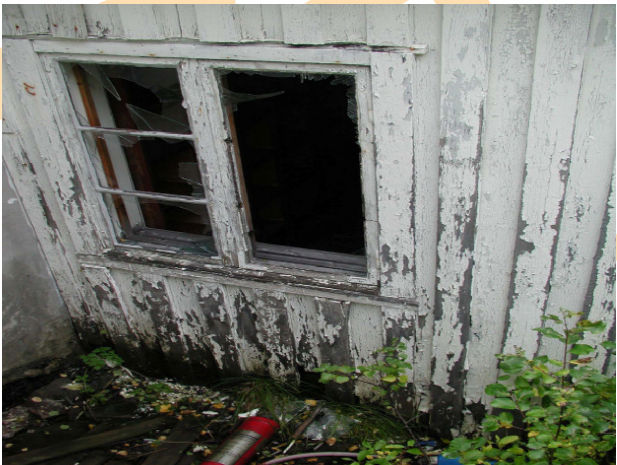
Det er vestveggen som er dårligst.
