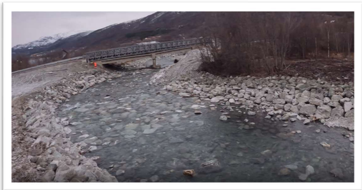
Figur 4.1. Bildet viser plastring av elvebunn og erosjonssikring av elvekant utført av Kvæningen kommune oppstrøms brua over Badderelva. Det fremgår også tydelig av bildet at en god del av kantvegetasjonen langs elva er borte etter flom/erosjon og påfølgende sikringstiltak. Foto: Statens vegvesen
