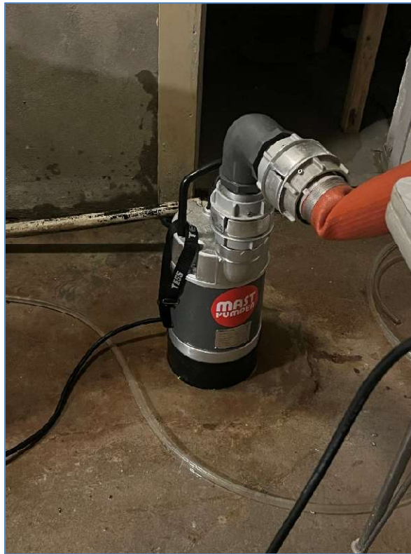
Figur 13 RVR-oppdrag etter vannskade i kjeller
